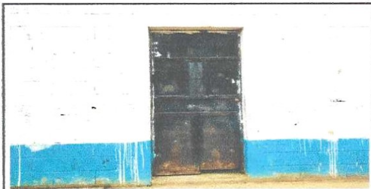
FOTO 5 DETERIORO DE PUERTA DE METAL
