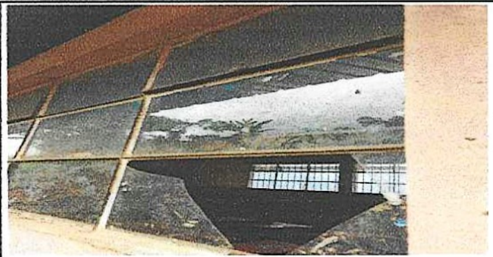
FOTO 9 SE OBSERVA DETERIORO DE LA VENTANAS
