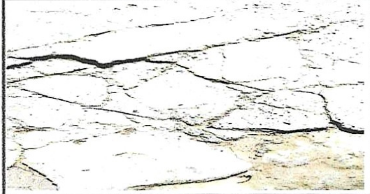
FOTO 8 SE NECESITA CAMBIO
