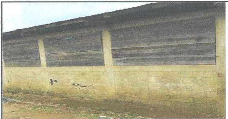
FOTO 3 DETERIORO DE PARED
