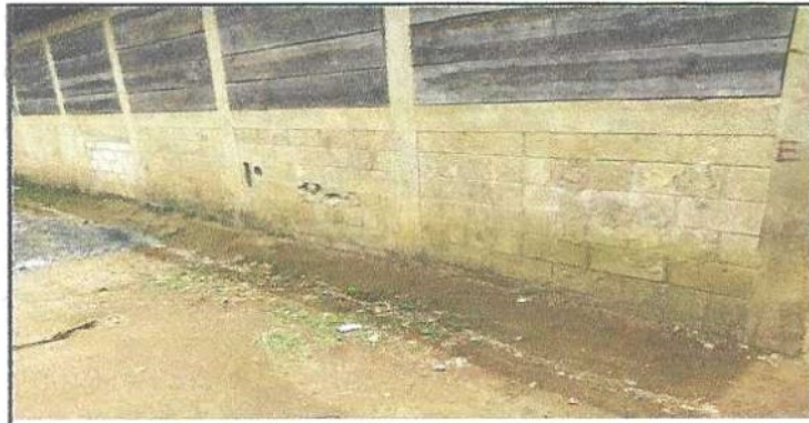
FOTO 4 SE NECESITA CAMBIO
