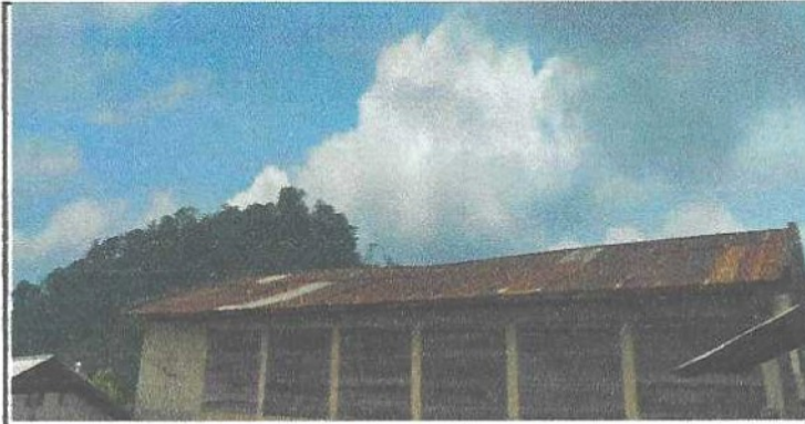
FOTO 1 SE OBSERVA EL DETERIORO DEL TECHO DE LAMINA
