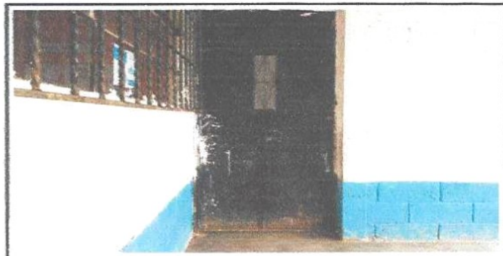
FOTO 6 SE NECESITA CAMBIO DE PUERTA
